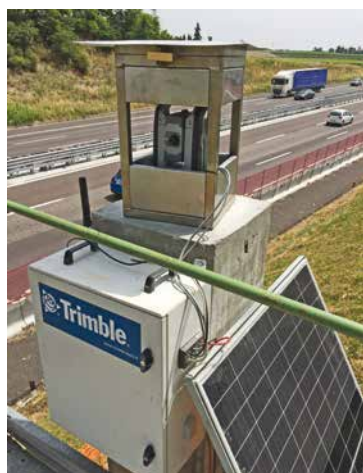
2. La postazione fissa di monitoraggio composta da stazione totale S9 0.5" Finelock DRHP, abitacolo di protezione, unità di ingegnerizzazione e pannello fotovoltaico
